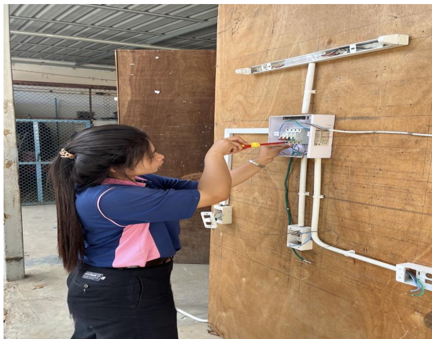
รูปภาพที่ 24 แสดงภาพการต่อสายเข้าตู้คอนซูมเมอร์
