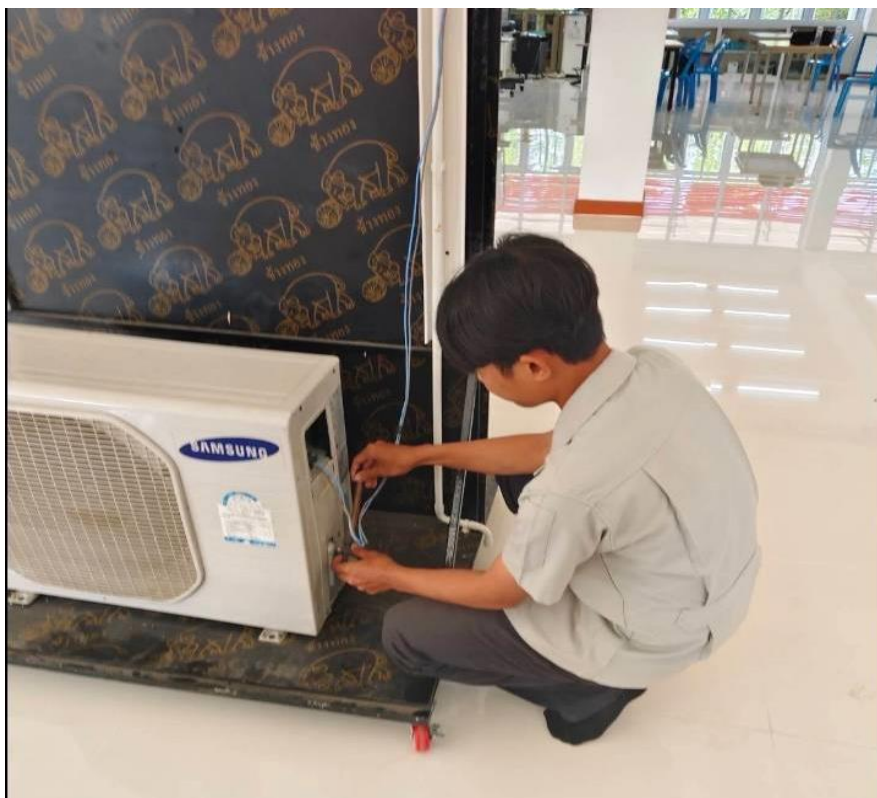
รูปภาพที่ 12 แสดงการเดินท่อและสายไฟชุดส่วนประกอบแอร์ด้านหลัง
