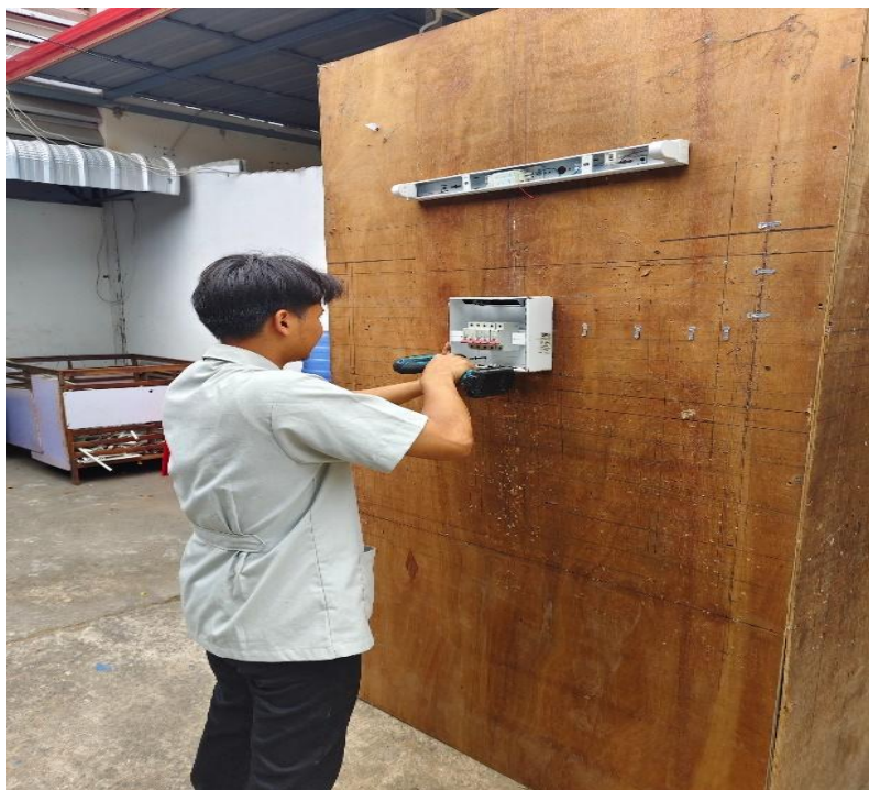
รูปภาพที่ 2 แสดงการติดตั้งตู้คอนซูมเมอร์
