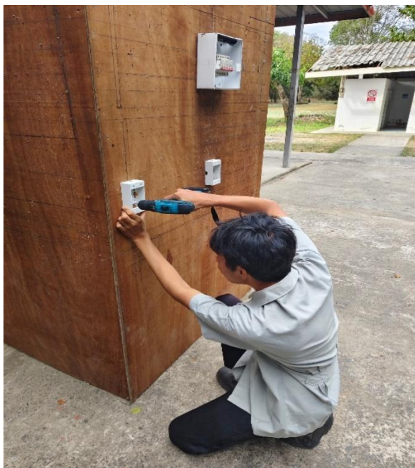
รูปภาพที่ 9 การติดตั้งปลั๊กคอลลอยชุดแผงสาธิตชุดทดสอบมาตรฐานฝีมือแรงงาน
