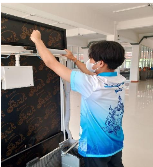
รูปภาพที่ 15 การพันเทปรวบรวม ท่อ และ สายไฟ ด้านหลัง
