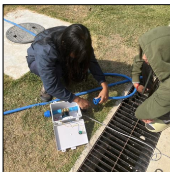
ภาพที่ 3.8 นำกล่องกันน้ำที่ติดตั้งอุปกรณ์ต่อเข้ากับระบบน้ำ
